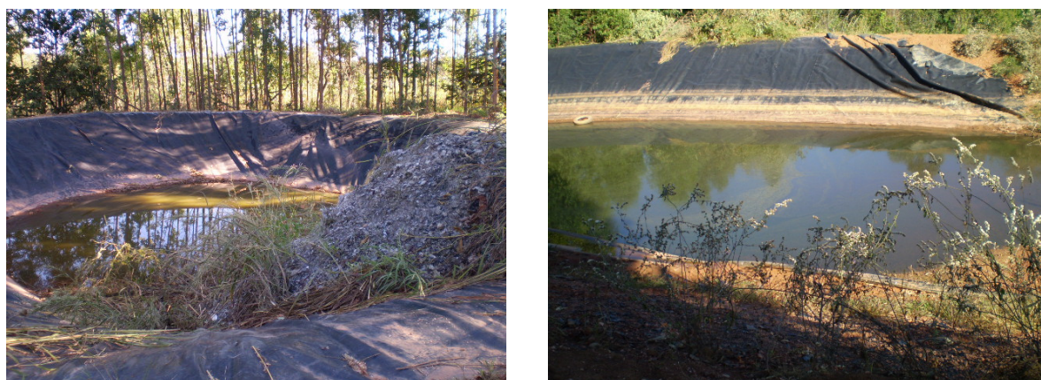
Figura 3: Vista da Lagoa de Chorume, mostrando a degradação da camada impermeabilizante.
